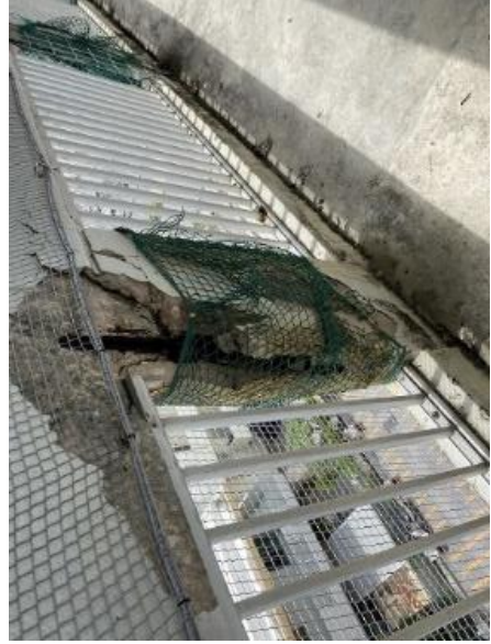
手すり崩落危機状況
